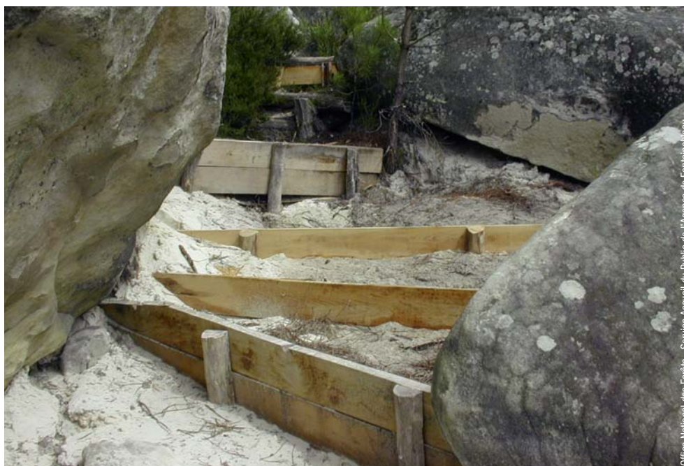
Exemple d'ouvrage anti-érosion aux Trois Pignons.
